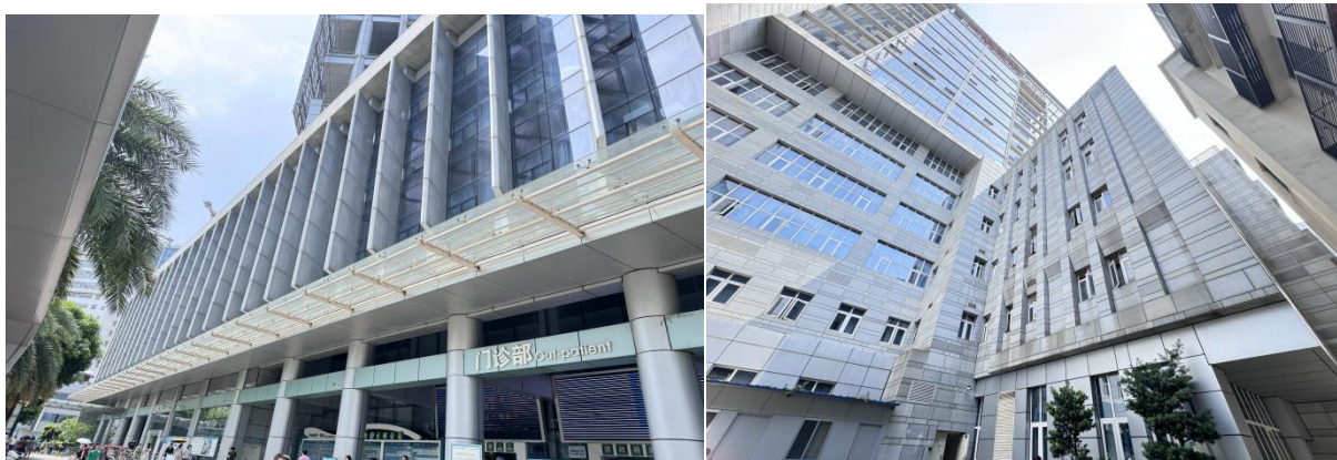
如图所示：建筑物表面有明显灰尘、污垢、流痕等现象
